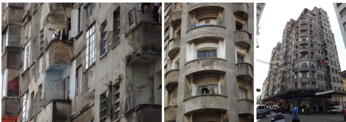
Figura 7. Exemplo de edifício deteriorado.
