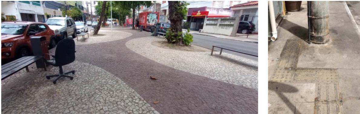
Figura 9. Pavimentação e obstrução de passeio: a) Canteiro Central; b) Lado A
