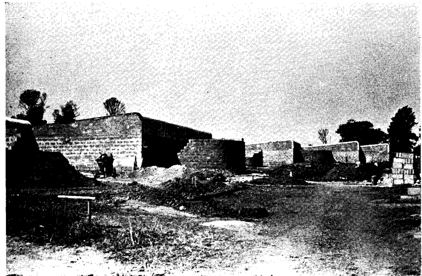
EST. II, B — Casas de tijolo e zinco, em construção em Kwaluseni. São imagem duma tentativa de resolução do problema habitacional da Suazilândia.
