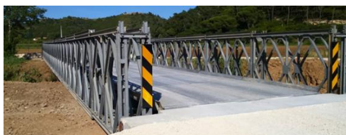
Figura 4 - Ponte Mabey Compact 200 DSHR2H++ montada na Carvoeira, Mafra, em 2017 (Ladeiras, 2017)
