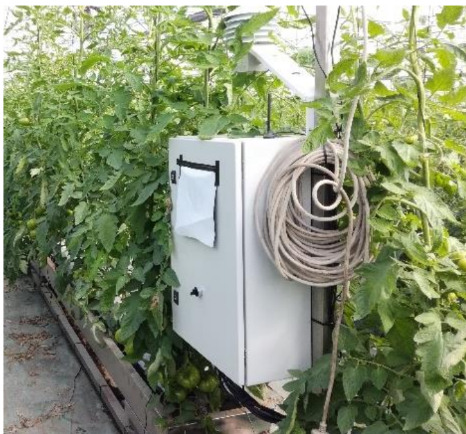
Figura 3: Unidade de controlo do equipamento. Sensores de temperatura e humidade (acima).
