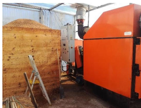
Figura 2: Depósito de caroço de azeitona e caldeira.
