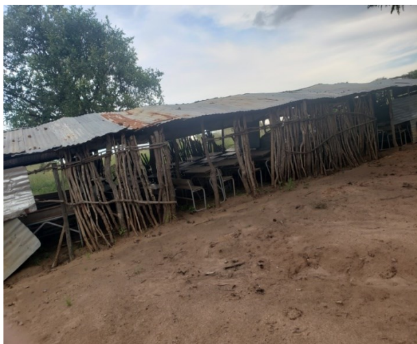
Figura 1: Algumas salas de aulas da EP2-Mussangadze avariada há 2 anos
