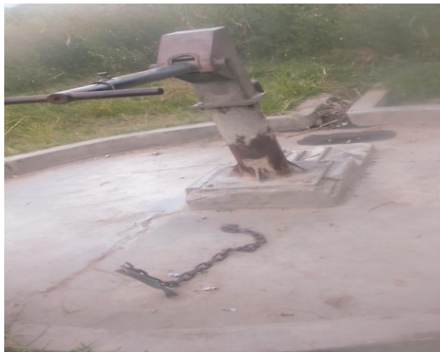
Figura 2: Uma das Bombas de água avariada há 2 anos
